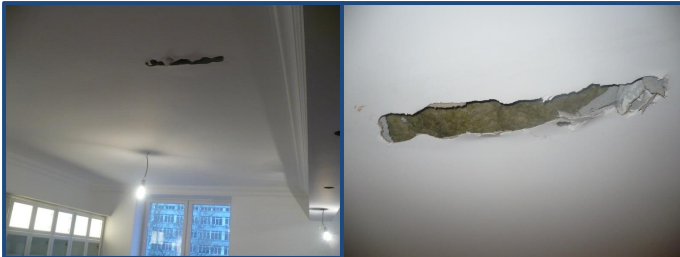
Примеры фотографий. Натяжной потолок (полотно лопнуло)
