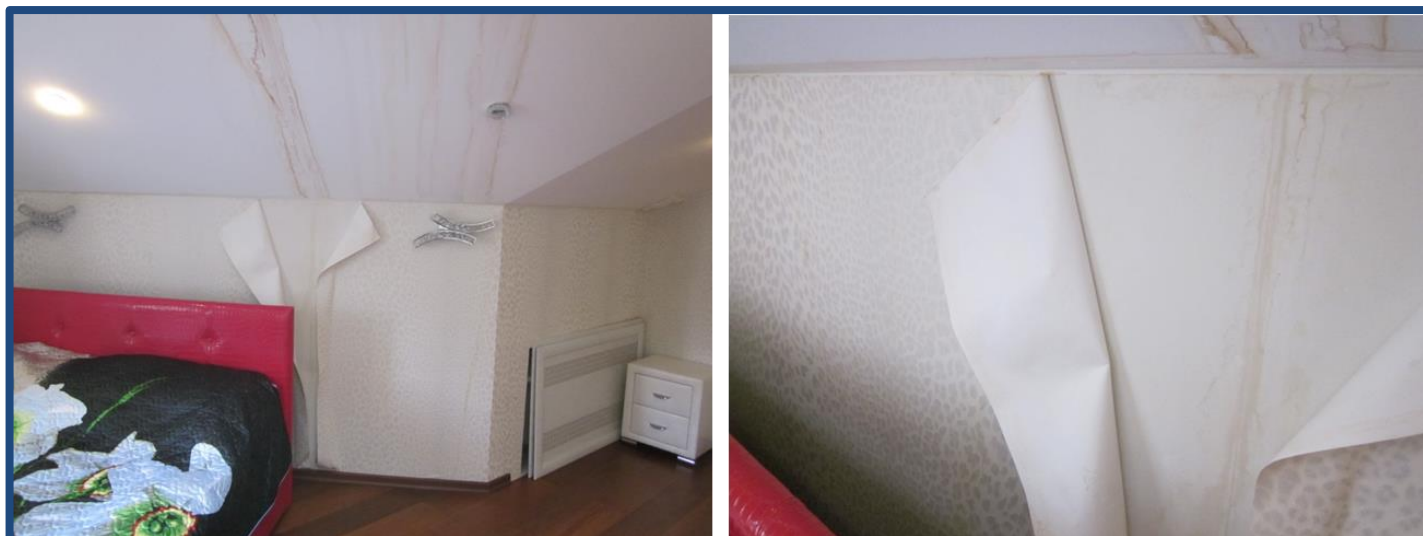
Примеры фотографий. Отслоение обоев и подтёки
